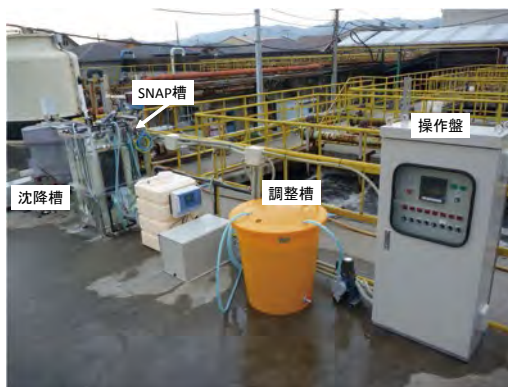
図 14. 一槽型アナモックス処理プラント（捺染染色業・A 社に設置）
