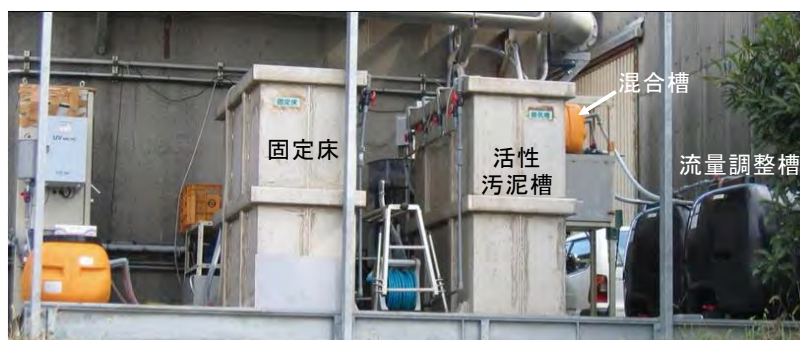
図 17. 排水処理パイロットプラント (みなべ町・B社)
