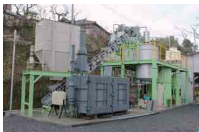
精油抽出試験プラント
