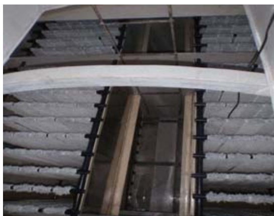
ユニット内部の固定化担体
