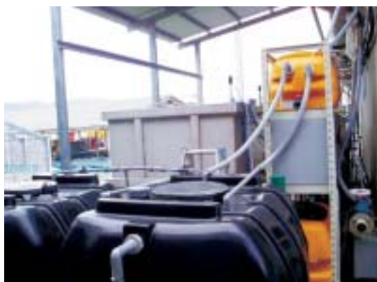
図1 パイロットプラント設置状況
